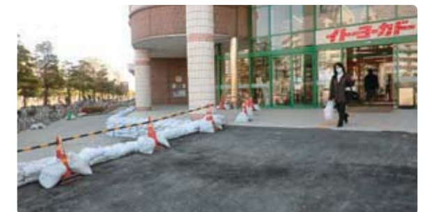
千葉のイトーヨーカドー浦安店では、液化現象による地盤沈下で歩道と店舗の間に最大70cmの段差が。急遽スロープをつくって対応。断水も続きました。
